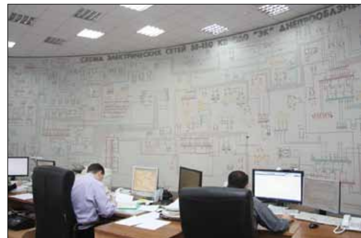
Диспетчерский центр позволяет наблюдать за состоянием энергетической системы всей Днепропетровской области
